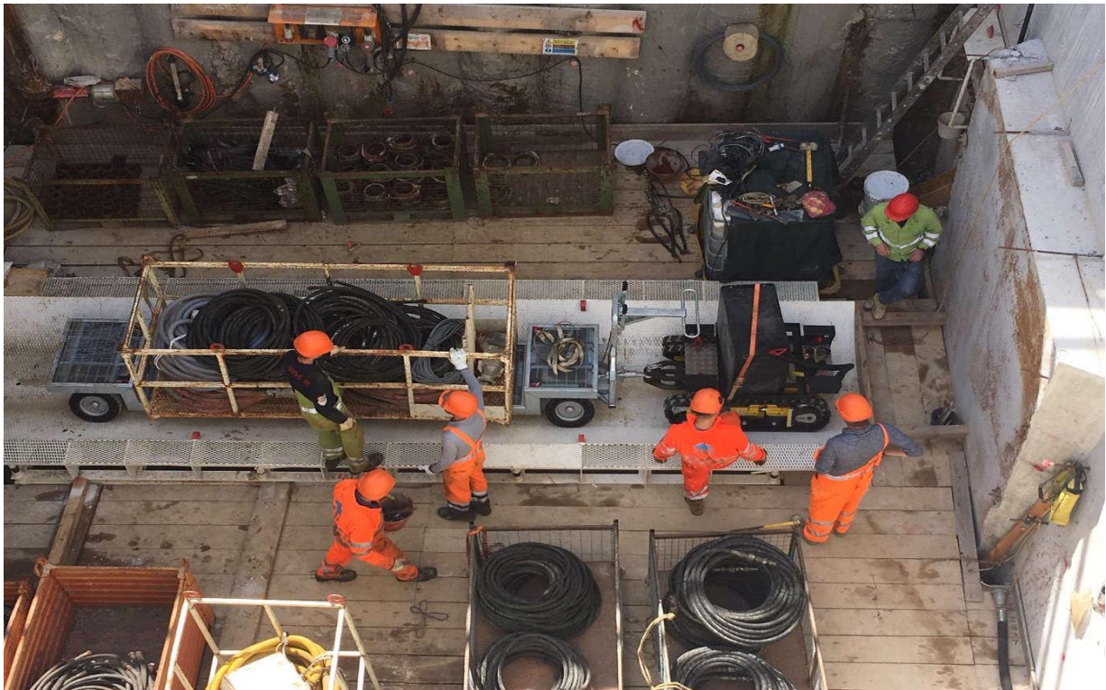
Foto 2 DCT450MT op de werklocatie gekoppeld aan de trailer
